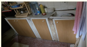
爆風と衝撃波で壊れたキッチンのフロアキャビネットに取り付けられた真新しい扉。
