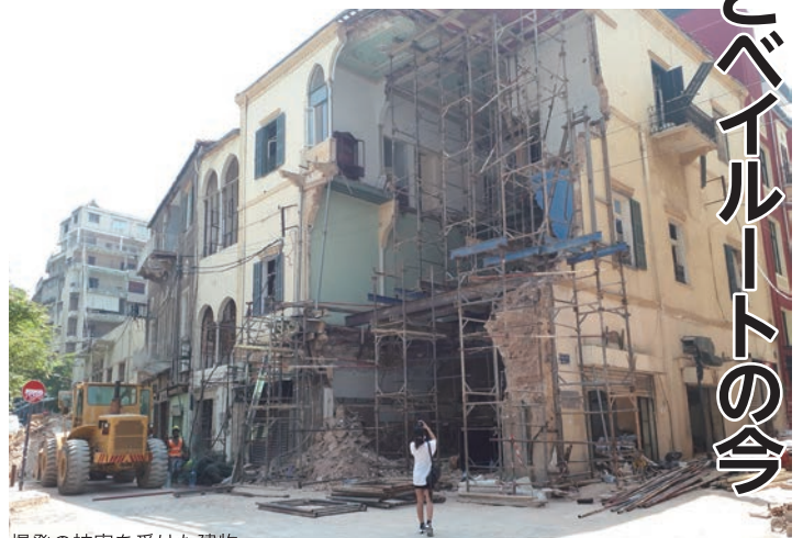
爆発の被害を受けた建物
