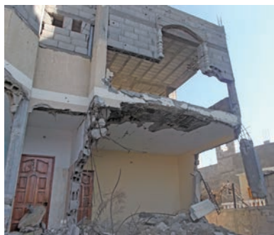
破壊されたまま修復が始められていないガザの住宅
