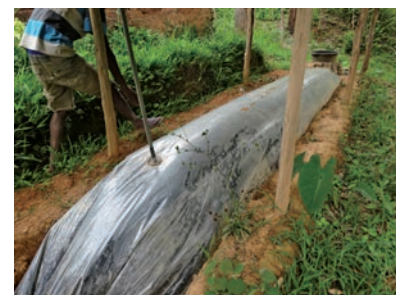
バイオガスプラントのようす
