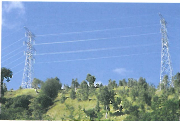
「全国に灯りを」。中国の援助で建設される重油発電所から配電する鉄柱群(2011年5月)
