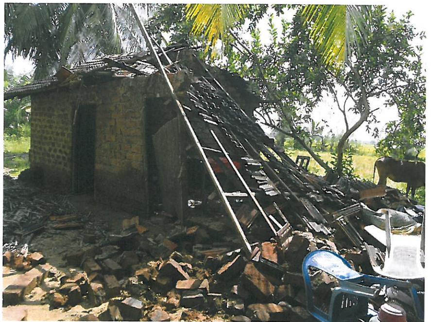
洪水で損壊した家屋
